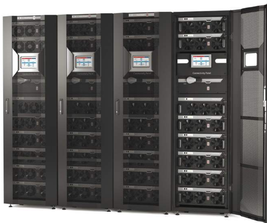
Силовой шкаф (1+7 x силовых модуля) x 4
